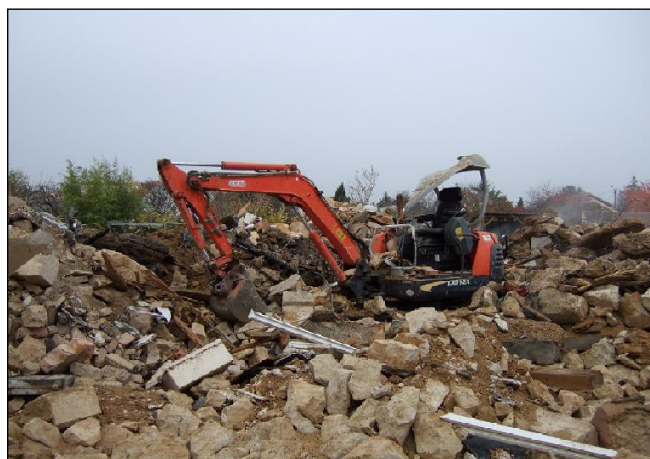
Niort (79) le 04/11/2007 Explosion d'un pavillon
