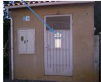
Transformateur cabine urbaine
