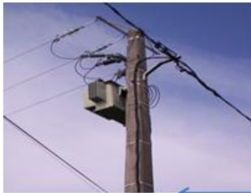
Transformateur aériens H61
