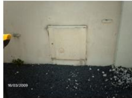
Coffret de raccordement individuel avec compteur
