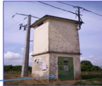
Transformateur cabine haute
