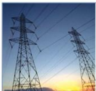
Réseau HTB (Haute Tension)
