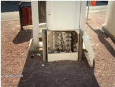
Coffret de réseau avec compteur
